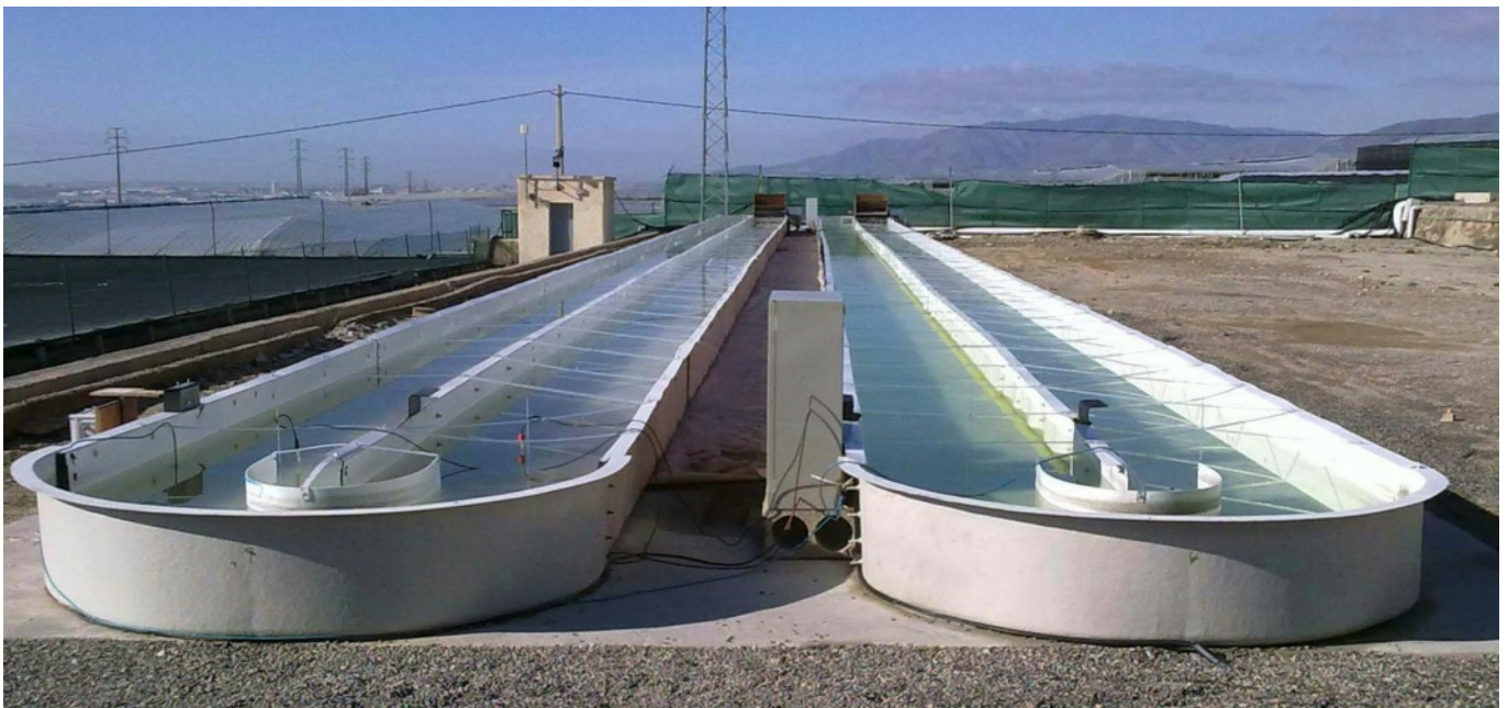
Figura1. Detalle de los fotobiorreactores utilizados localizados en la Estación Experimental Cajamar.
