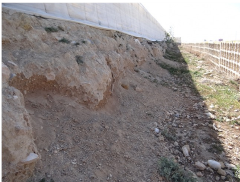
Figura 8: Ejemplo de talud donde sería recomendable un seto para zonas erosionadas y taludes
