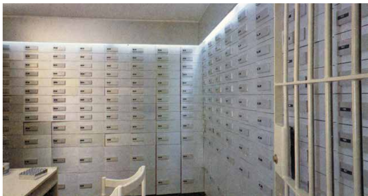
Nueva dependencia de cajas fuertes para socios y clientes.
