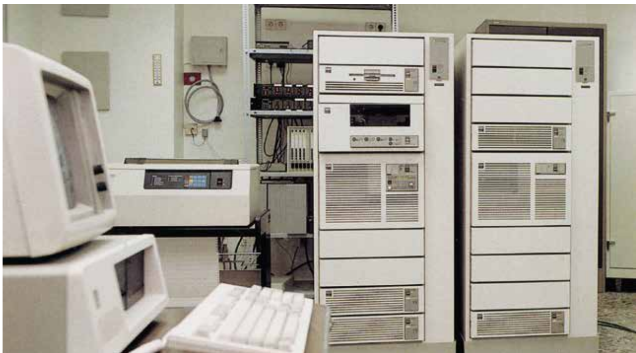
Instalaciones del departamento y centro de proceso de datos.
